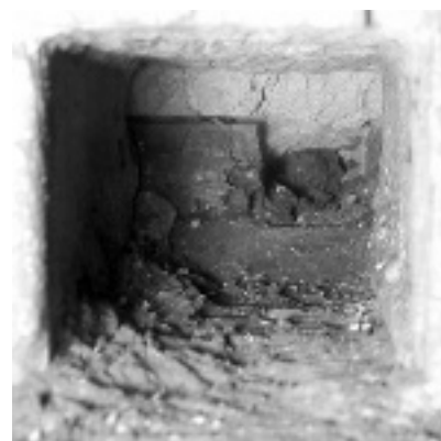
Fig. 9 : Trou de boulin S3. Le boulin a disparu, on observe une poutre transversale qui présente une encoche à mi-bois.
